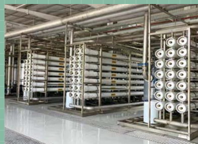
水資源再利用のための 逆浸透膜 (RO) 水再生処理システム
